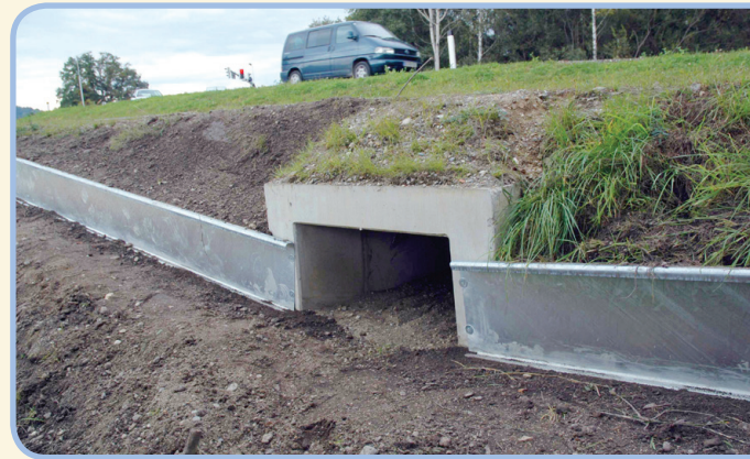
Neu eingebaute Tunnel-Leit-Anlage
